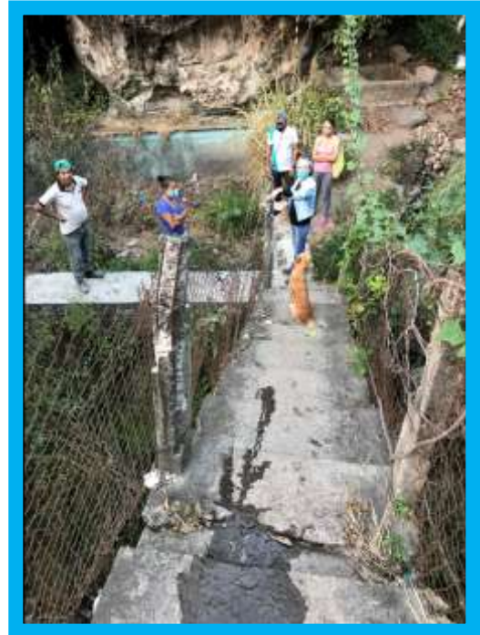
Necesitan cemento y varilla para cambiar el puente-escalera que cruza el río, mismo que está fracturado.
